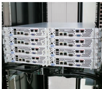
直流給電方式の採用によって、安全かつ高効率な直流給電を実現しながら、従来の交流給電に比べ、システム全体の電力効率を10%以上改善することも可能となった。
