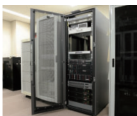
10台のサーバを仮想化することで、サーバルームを有効に使うことができる。
